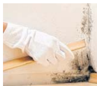
Das sieht nicht gut aus: Eine Schimmelecke. FOTO: VZ
